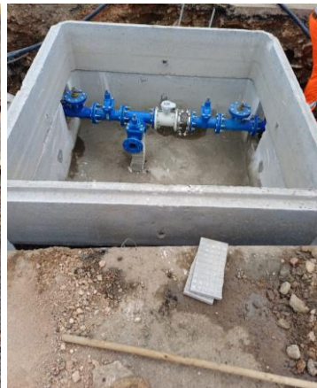
postazione di misura della portata
