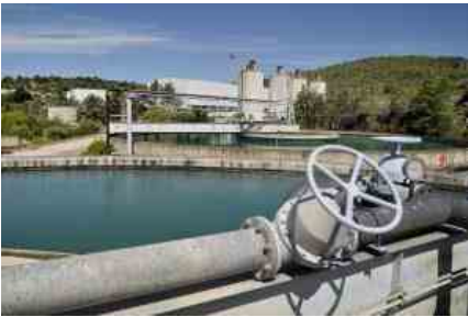
AQP, ACQUEDOTTO PUGLIESE, NELLA FOTO LE VASCHE DELL'IMPIANTO DI POTABILIZZAZIONE DEL SINNICHÉ CHE PORTA ACQUA VERSO BARI E TARANTO
