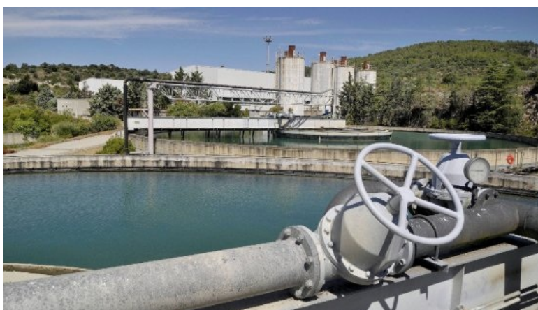
Un impianto dell'Acquedotto pugliese
