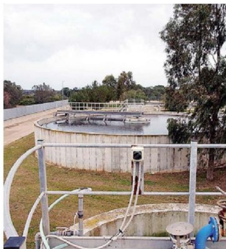
AQP Il depuratore di Melendugno, nel Salento
