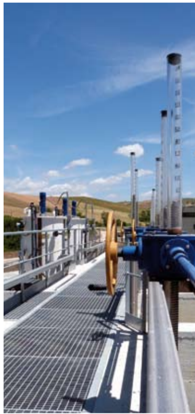
Il depuratore di Conza
